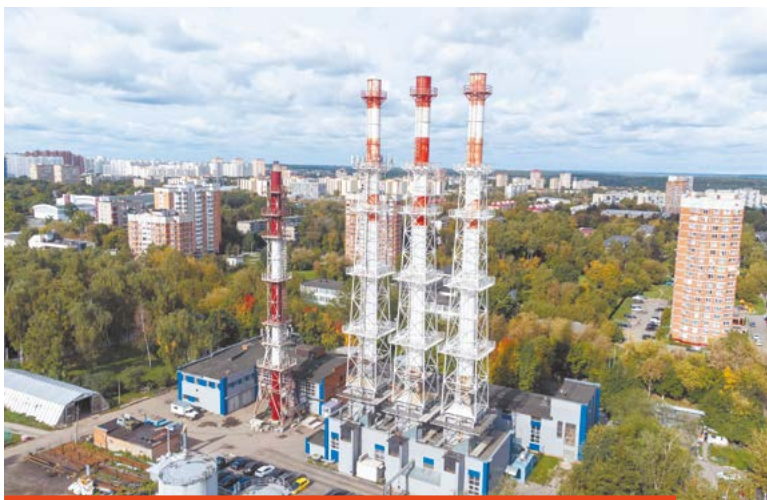
С 10 СЕНТЯБРЯ В ПОДОЛЬСКЕ НАЧАТЫ ПРОБНЫЕ ТОПКИ С ПОЭТАПНЫМ ПУСКОМ КОТЕЛЬНЫХ В ОТОПИТЕЛЬНЫЙ РЕЖИМ
